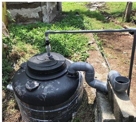
Gambar 5. Biogas Digester Buatan Peternak
